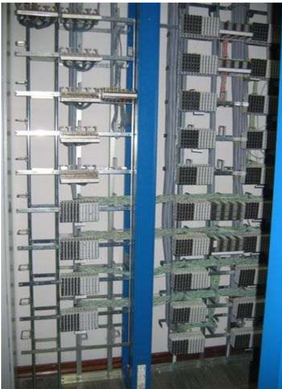
Figura 20: Ripartitore elettrico monofronte 10 livelli
