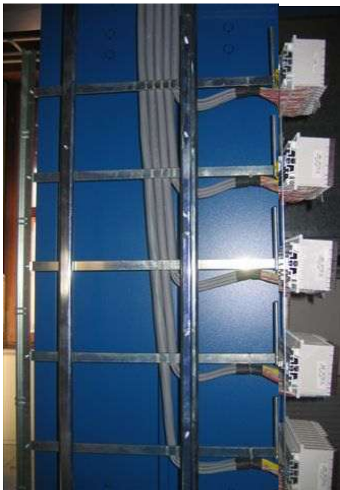
Figura 35: Discesa cavi su Ripartitore doppio fronte
