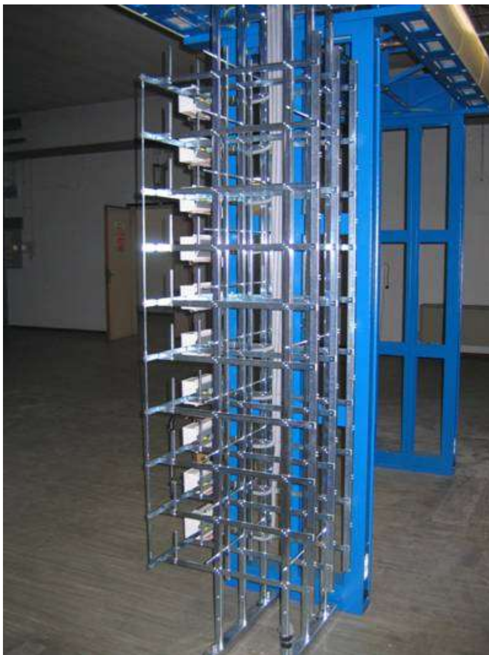
Figura 19: Ripartitore elettrico doppio fronte 10 livelli
