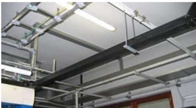
Figura 16 Canalina F.O. Interfila
