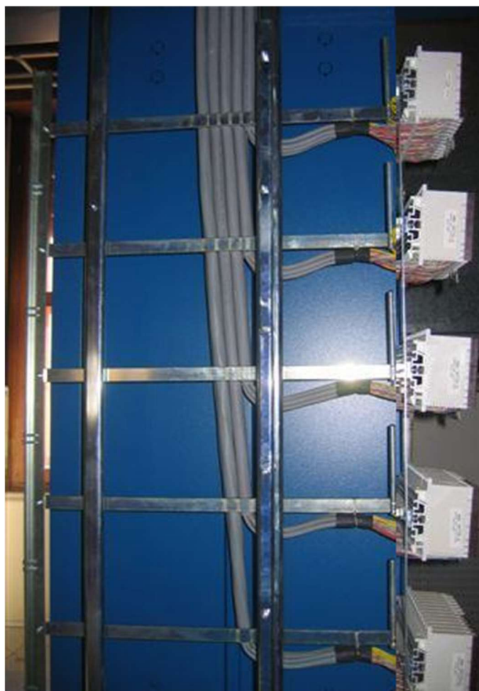
Figura 33 Discesa cavi su Ripartitore Doppio fronte
