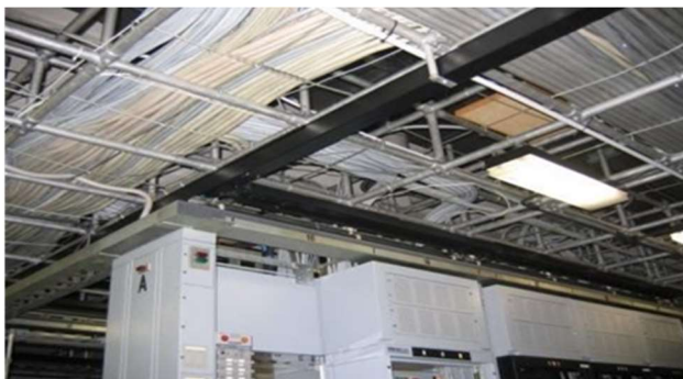
Figura 17 Canalina F.O. Interfila/Lungofila
