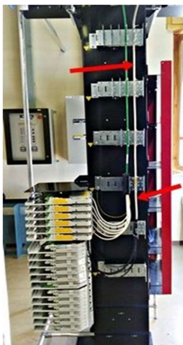
Figura 36 Discesa cavo Break-out su PO
