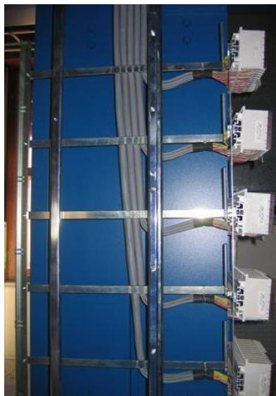
Figura 33 Discesa cavi su Ripartitore Doppio fronte
