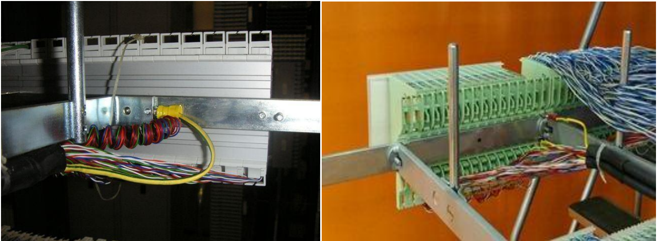
Figura 43A – A sinistra coppie di scorta avvolte in un'unica spirulina dietro la striscia IDC per cablaggi OAO. A destra vista posteriore della striscia ADSL al Permutatore
