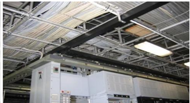
Figura 17A Canalina F.O. Interfila/Lungofila
