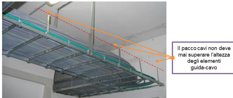
Figura 24A Esempio di occupazione del supporto cavi
