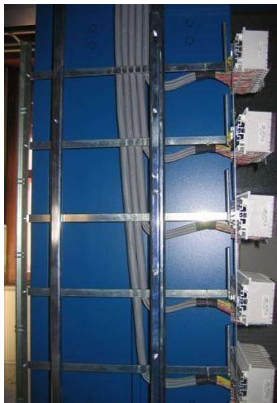
Figura 33A Discesa cavi su Ripartitore Doppio fronte
